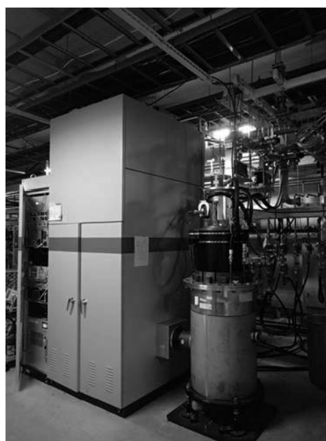
図 4 KEKB LINAC 大電力 RF ユニット。
