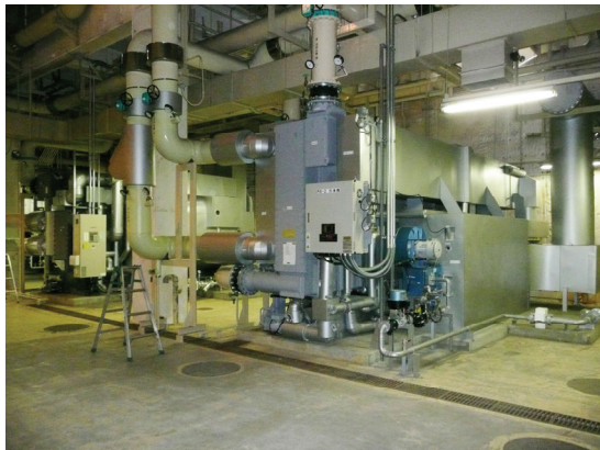
図 2-88 エネセンの冷凍機
