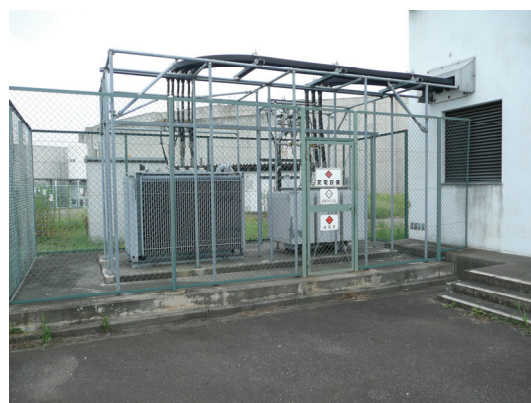
図 2-85 PF 電源棟の変電設備
