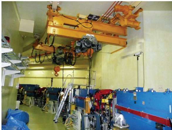
図 2-97 リングトンネル内のクレーン
