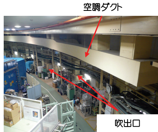
(b) リングトンネル内の空調
