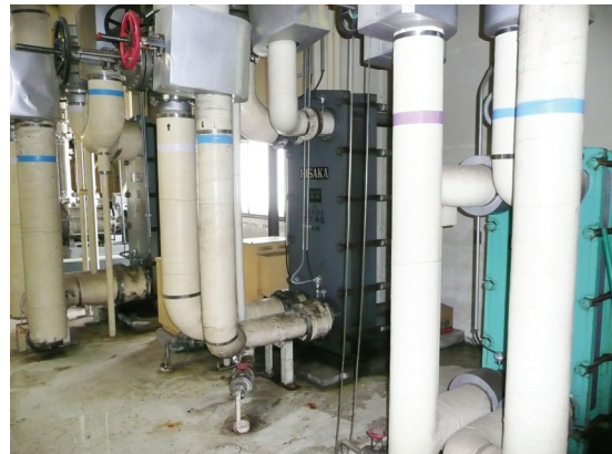
図 2-91 電源棟の熱交換機
