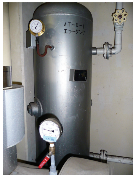
図 2-93 エアータンク
