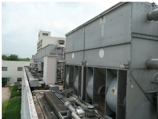
図 2-90 電源棟の冷却塔
