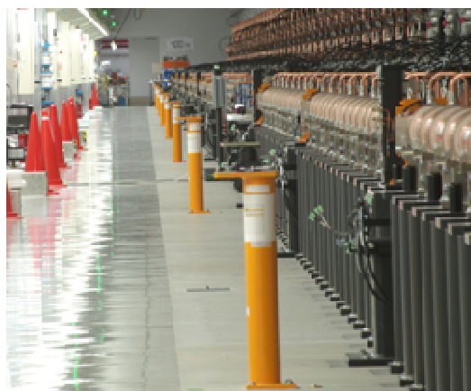
Fig. 4-2-1 測量用モニュメント(オレンジのポール)。約 30m 間隔で一直線に並んでいる。
