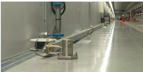
Fig. 7-1-1 収納部の床面に設置された HLS。手前の円筒がセンサー部、後ろの角パイプが水配管。
