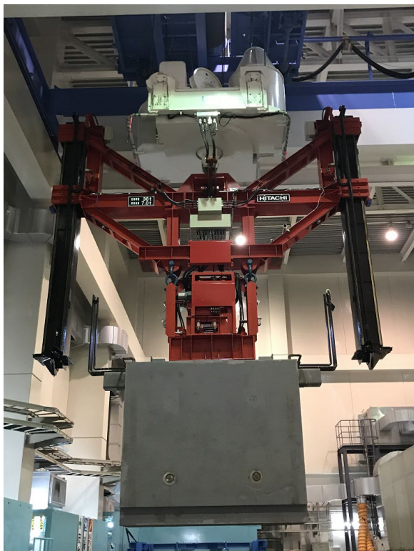
Fig. 27 ハンドリング装置に吊られた鉄遮蔽体
