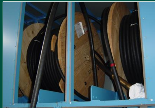
・PFNケーブルドラム:2枠 エネルギー蓄電・パルス出力用
