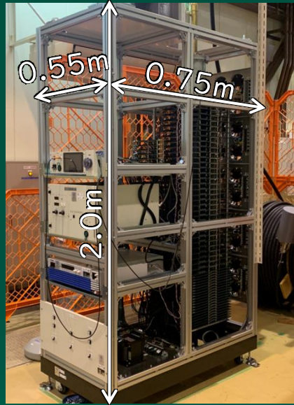
【新キッカー電源(1ユニット)】
