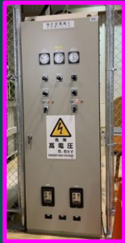
高圧受電盤 (VCB)
