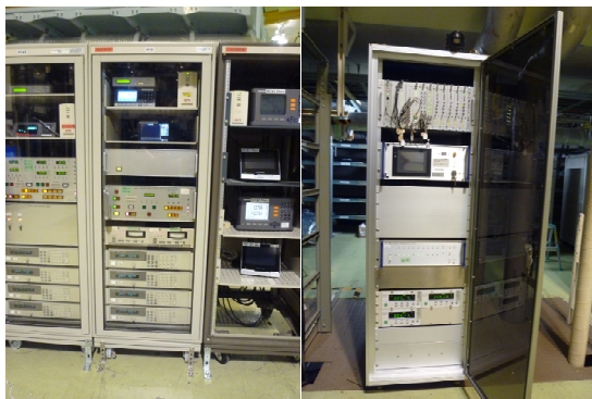
Fig. 5.17 ID15 制御ラック (左)、BL15 チャンネル制御ラック (右)
